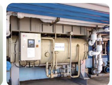
廢熱製冷 吸收式冰水主機
