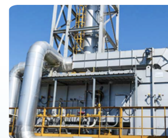
蓄熱式焚化爐
